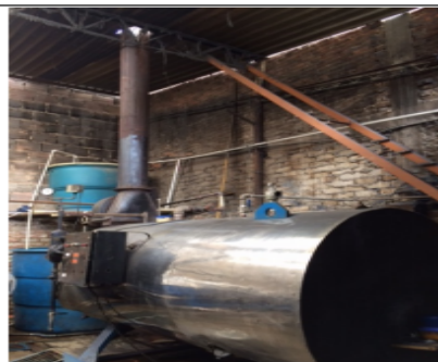
FOTOGRAFÍA 2: CALDERA 40 BHP Y DUCTO
